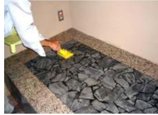
岩盤浴 抗菌・清掃メンテナンス軽減施工
